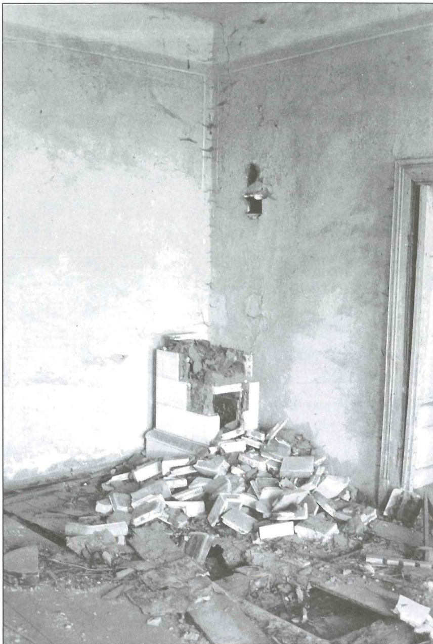
Obr. 10. Petrovice (okr. Benešov), trosky bývalých kamen v patře dokumentují současný stav zámku. Stav 13. ledna 2001, foto autor.
