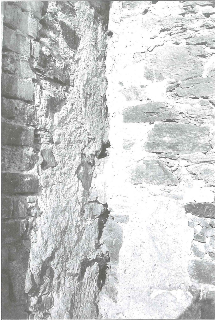
Obr. 8. Petrovice (okr. Benešov), výrazná spára, oddělující starší zdivo zámku vlevo od přístavby věžovitého rizalitu vpravo. Stav 13. ledna 2001, foto autor.
